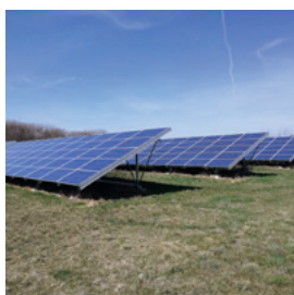
NORDENDORF, DEUTSCHLAND 7,5 MWp in Betrieb seit Dezember 2009
